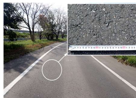
写真－4.5 50 万輪走行後のひび割れ発生状況
