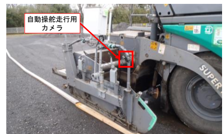
写真-3 自動操舵走行用カメラ
